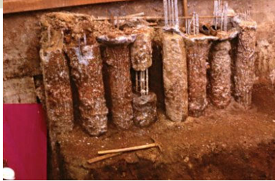
Estacas com problemas de integridade
